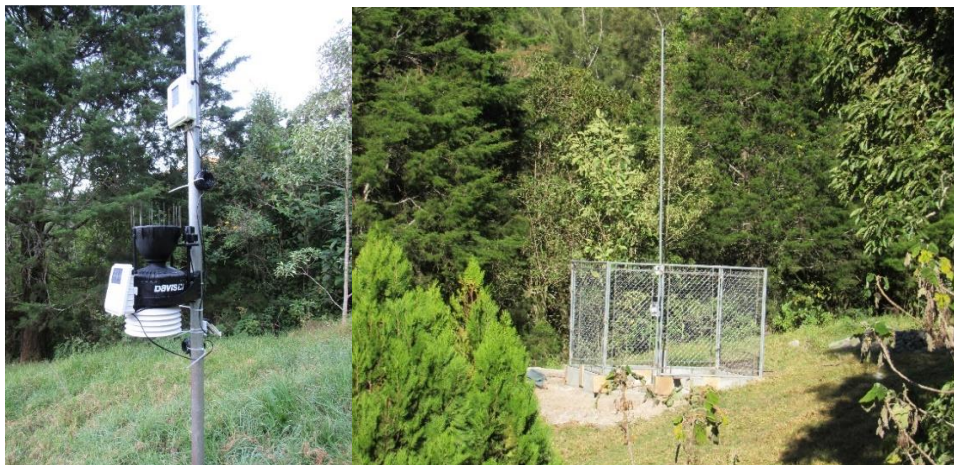
Figura 21. Estación Agro-meteorológica instalada para medición de parámetros ambientales en finca Rincón Paraíso, San Martín Sacatepéquez, Quetzaltenango.
